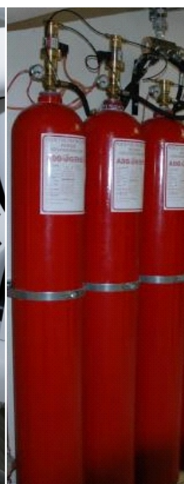
Stingere automată incendiu
