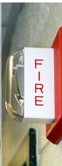
Alarmare și semnalizare
